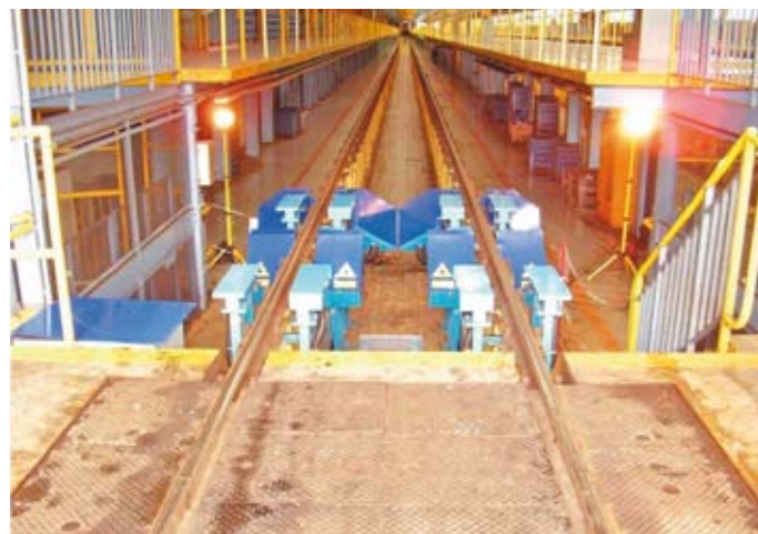
▲ Blick in die Wartungshalle bei PKP Intercity
